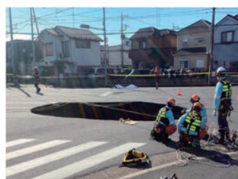
写真：道路陥没の事例
